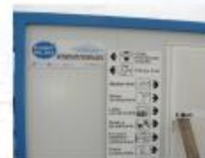
Fotografia del "punt blau" instal·lat
