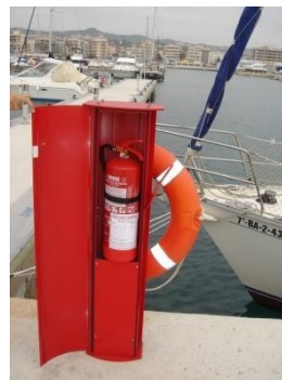
Extintors als pantalans
